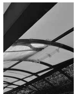
シエルトー破損箇所
