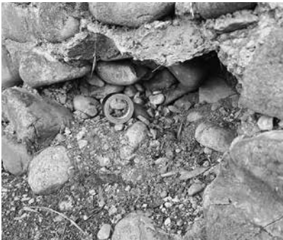
擁壁の欠損箇所
