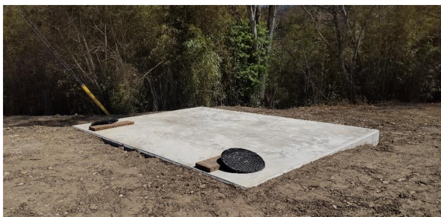
↑ 上生坂区梅月地区 防火水槽（新設）
