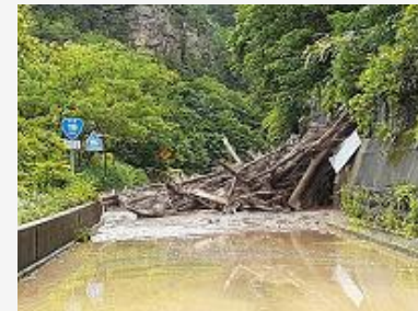
豪雨による国道19号土砂崩れ
