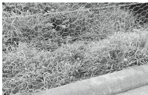
↑ 獣による柵の破損
